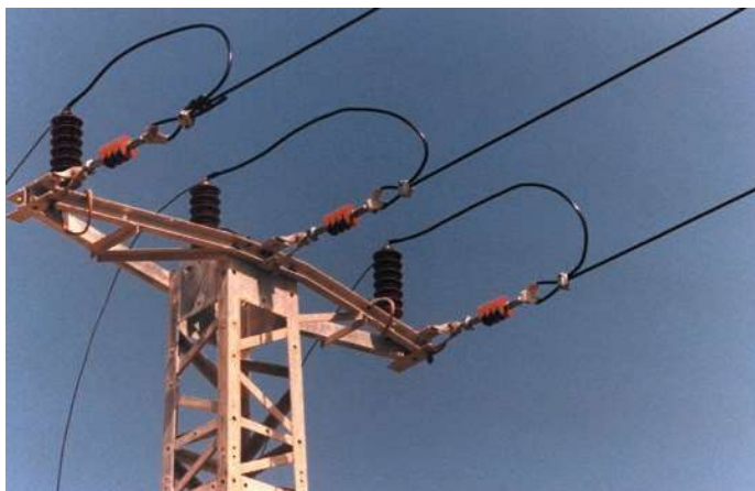
Zugisolator in Verbundbauweise
